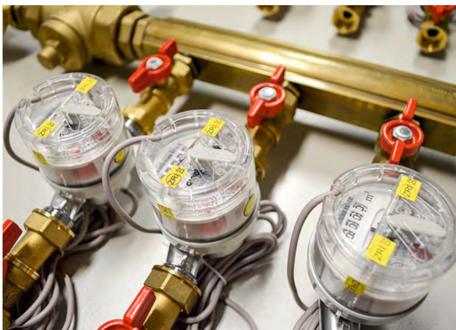
❖❖ Отводы распределительного узла с водосчётчиками
